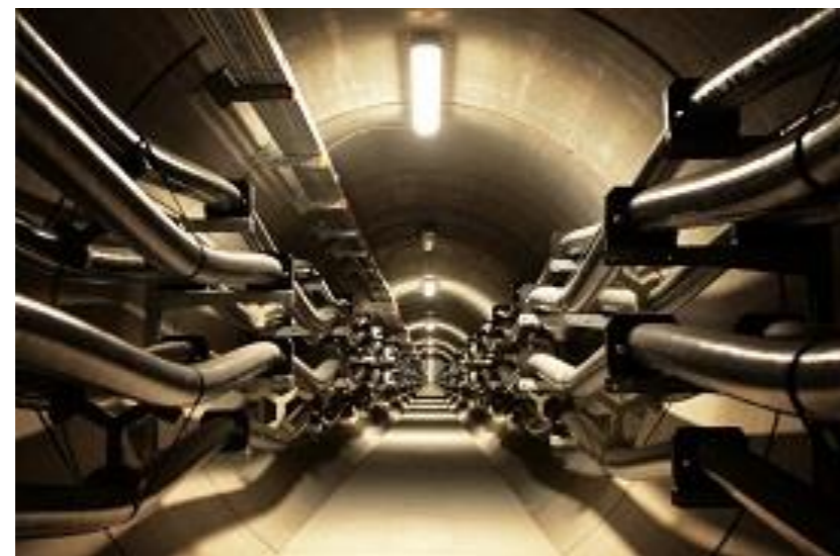
La Bâtiaz SWISSGRID
