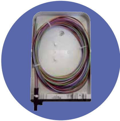
Rückziehen und Aufrollen des Nanokabels in der MCO-Dose
