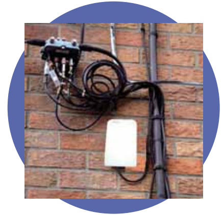
Neben Koaxialkabel installierte MCO-Dose
